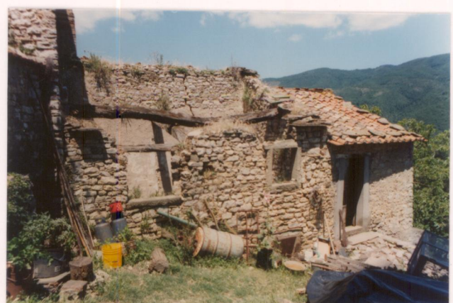
p.v. N. 20 strutture fatiscenti
