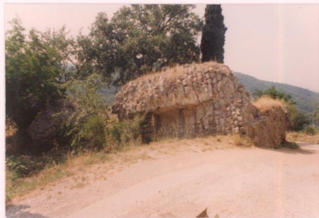
p.v. N. 8. Spezzone delle mura crollato al di là della strada
